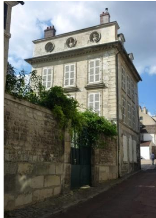
La hauteur insuffisante du mur nécessite son interruption par des piliers
