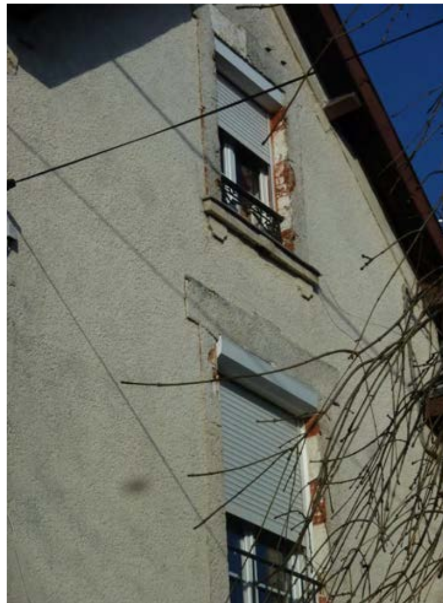
Exemple de mise en œuvre d'un enduit projeté sur l'ensemble de la façade (y compris sur les encadrements en brique) - rue P. Lavoye
