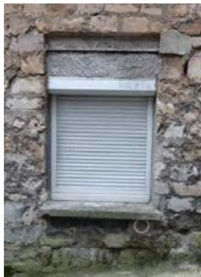
Modification radicale de la façade due à la réduction de l'ouverture et à la pose de ce volet roulant en PVC à coffre extérieur
