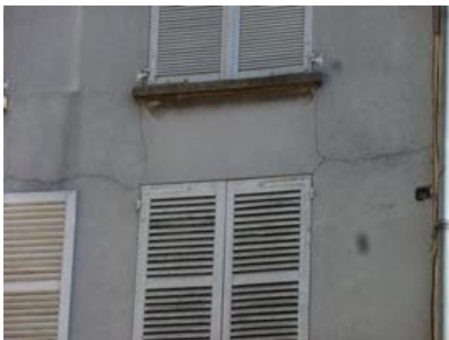
Enduits en ciment fissurés - rue de l'Hôtel de Ville
