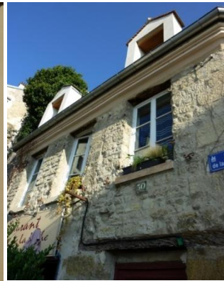
Maçonneries mises à nu et fortement dégradées (piochage des enduits, gel, pluies, etc...)
