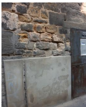
Application d'un enduit ciment sur pierres de taille ayant entraîné la dégradation de la pierre
