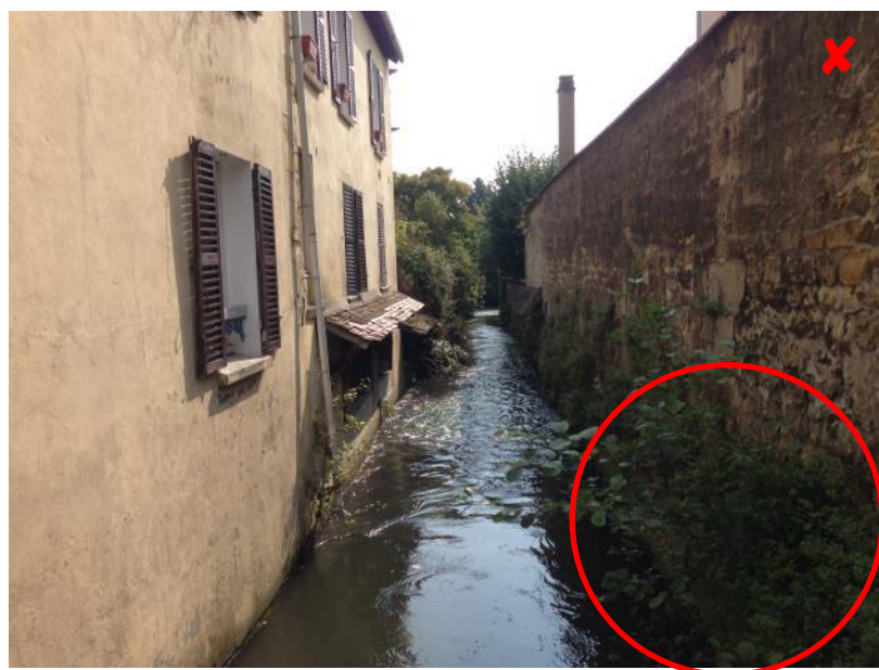
Végétation spontanée risquant de mettre en péril les maçonneries. (Rue de Rouen)
