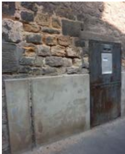
Soubassement en ciment accentuant la dégradation des pierres
