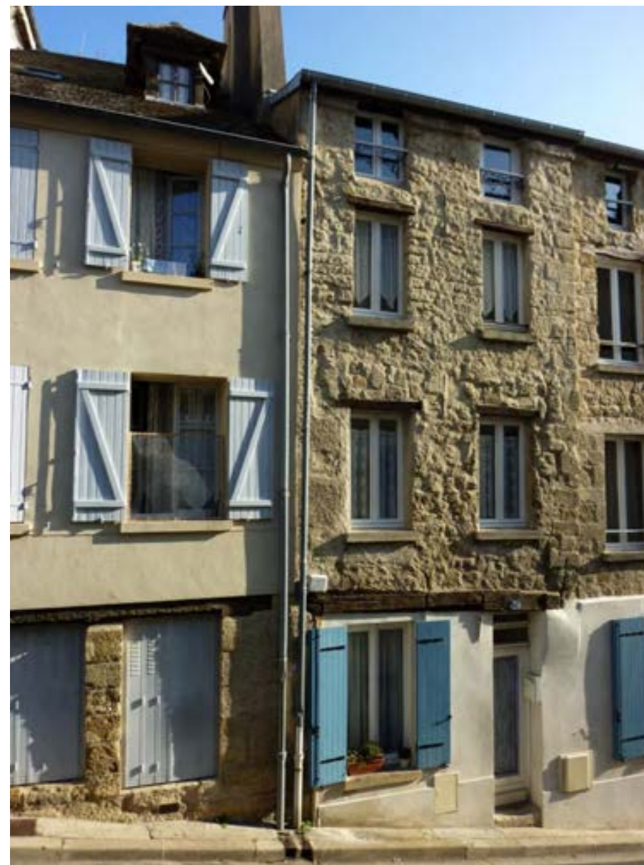
Différents stades d'altérations sur ces constructions - rue de la Roche
