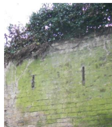
Prolifération de colonies végétales qui à terme rongent de façon irréversible le calcin de la pierre
