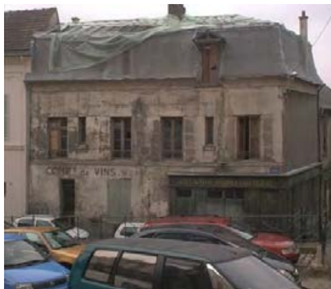
Immeuble en état de délabrement présentant un pastiche de vitrine commerciale parisienne du début 20 ème .
