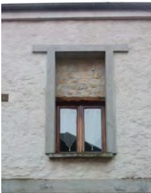
Réduction d'une baie suite à la création d'un plancher - rue des Maréchaux
