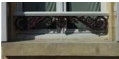
Garde-corps en fonte – période Louis Philippe
