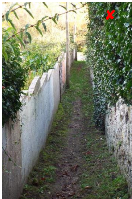
Mur béton peu qualitatif à proscrire (Ruelle des Poulies)
