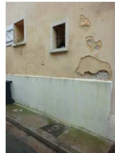
Sols imperméables amplifiant les remontées capillaires dégradant le mur
