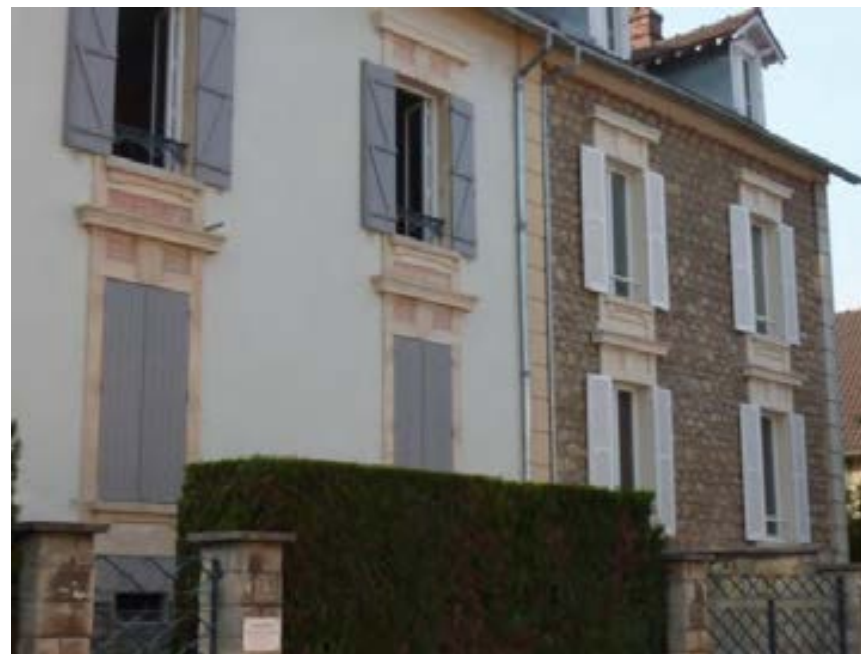
À gauche: façade ayant conservé son enduit. A droite: les maçonneries hétérogènes autrefois protégées par un enduit ont été mises à nu.
