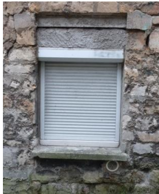
Modification radicale de la façade due à la réduction de l'ouverture et à la pose de ce volet roulant en PVC à coffre extérieur
