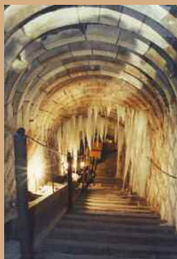
À la suite d'une rupture de canalisation au cours de l'hiver 1997, des stalactites de glace se sont formées dans l'escalier sud de la Cave des Moineaux. Le sous-sol de Pontoise est stable, les carrières sont présentes depuis plusieurs siècles.
