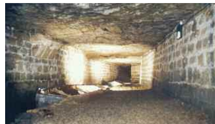
La cave du pont est souvent évoquée comme étant un ancien port souterrain. Mais des indices nous montrent que ce n'est pas possible. Tout d'abord, l'Oise se situait à un niveau inférieur, elle n'a été canalisée qu'au XIX ème siècle. Enfin cette affirmation vient du fait que le dernier propriétaire y avait aménagé un quai et placé une barque ce qui donnait l'impression au visiteur d'être dans un port, mais ce n'était que pure imagination.
